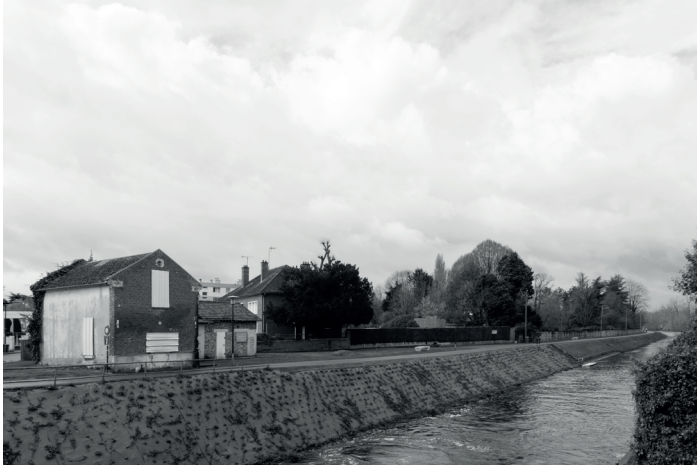
Le site de projet, avec l'ancienne maison éclusière. Son état de dégradation trop avancé n'a pas permis sa conservation, malgré les tentatives.
